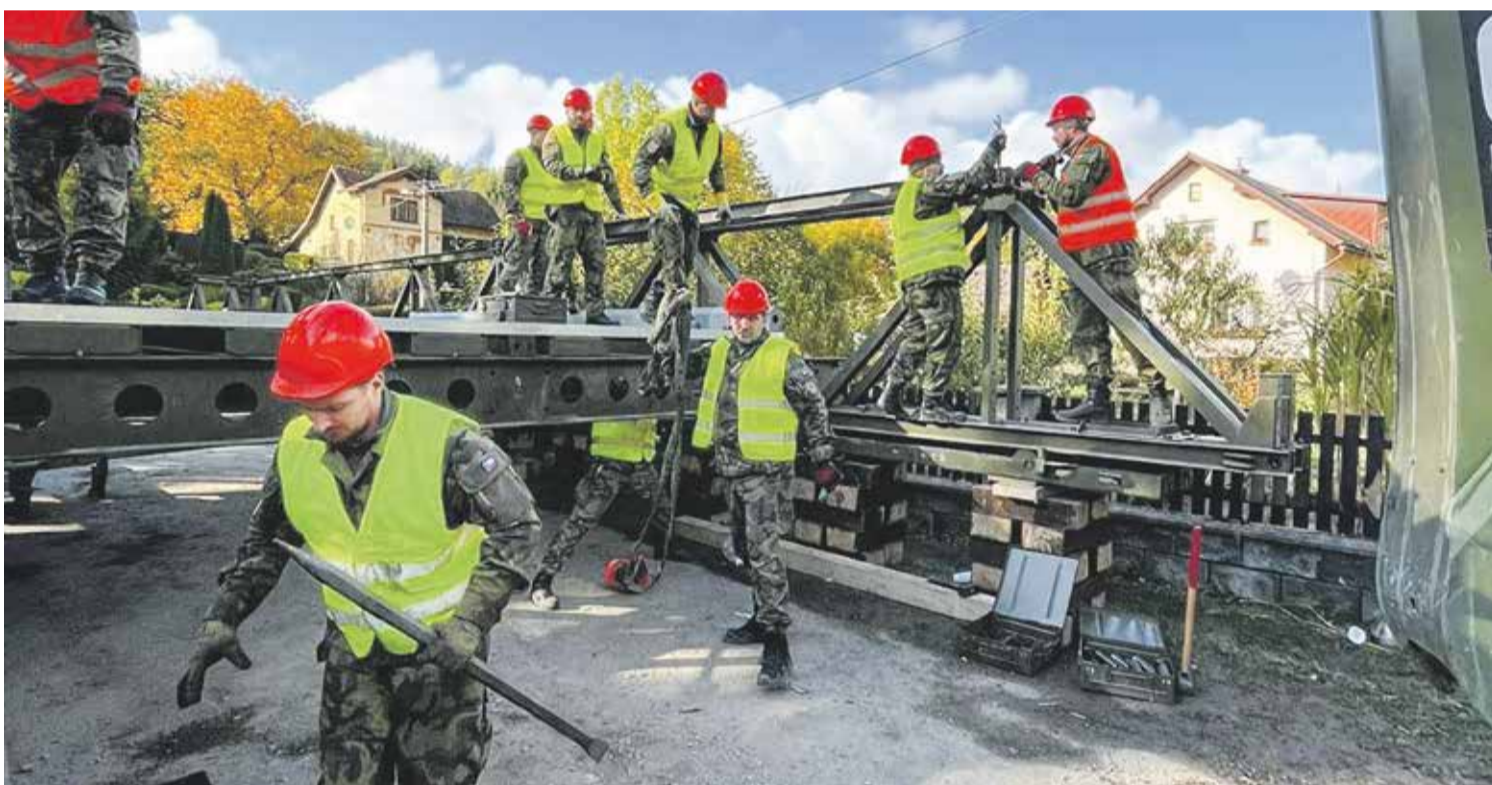
Největší škody napáchala voda na infrastruktuře.
